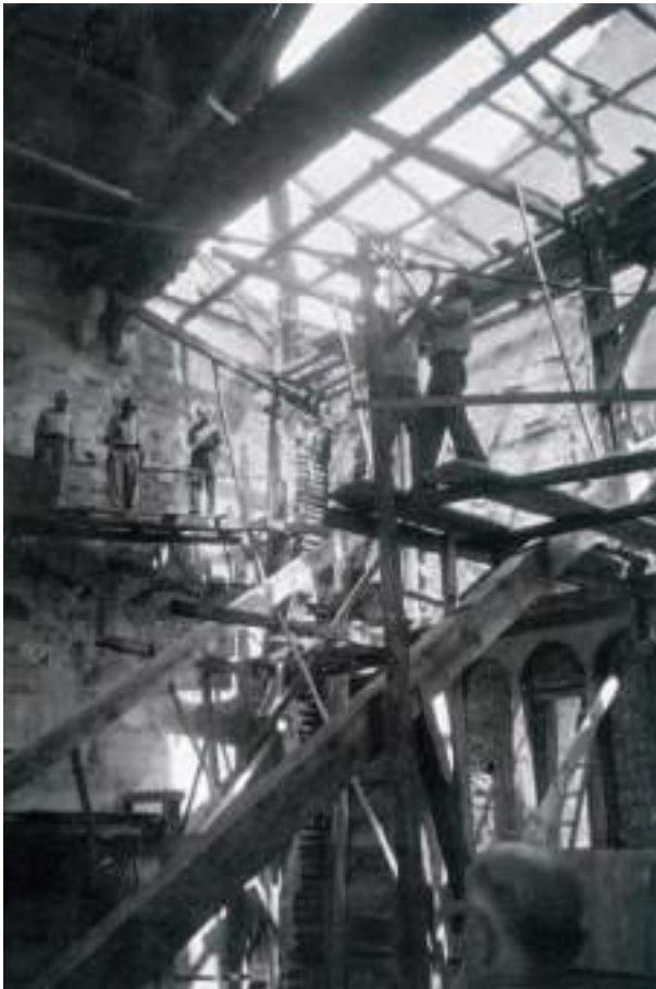
6. Treviso, palazzo dei Trecento dopo i bombardamenti del 1944. La porzione sud crollata (Iuav, AP, s.d., inv. 4242)
