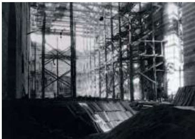
5. Padova, chiesa degli Eremitani. Lavori preparatori per il raddrizzamento dell'ultima parte della muratura strapiombante a nord, 1945 (Iuav, AP, s.d., inv. 4684)
