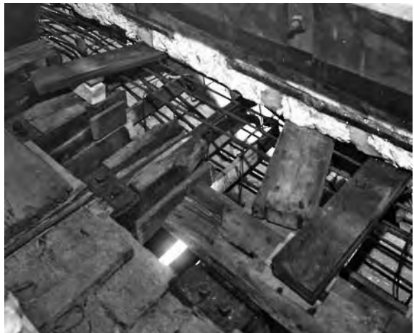
7. Venezia, Ca' d'Oro, restauri 1929-1936. Staffe predisposte per fissare le teste al cordolo di collegamento al primo livello (Iuav, AP, FFT, inv. 811, part.)
