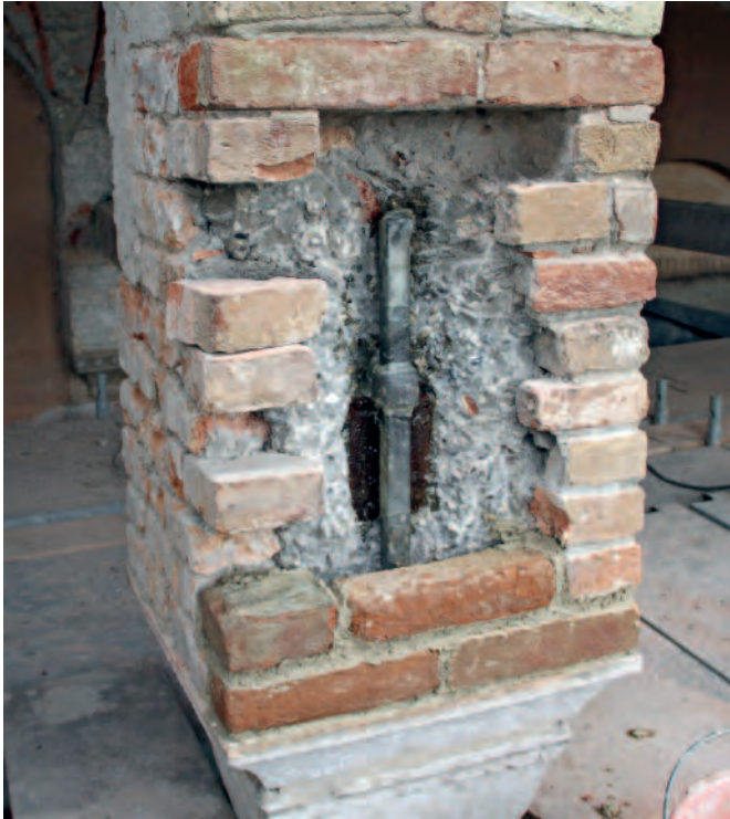
14. Torcello, chiesa di Santa Fosca. Capochiave a bolzone, sostituito nell'intervento di Forlati (1929-1938), bloccato insieme alla trave in un nucleo di calcestruzzo all'interno di un peduccio del portico nord (2015, foto Studio Tocchi)
